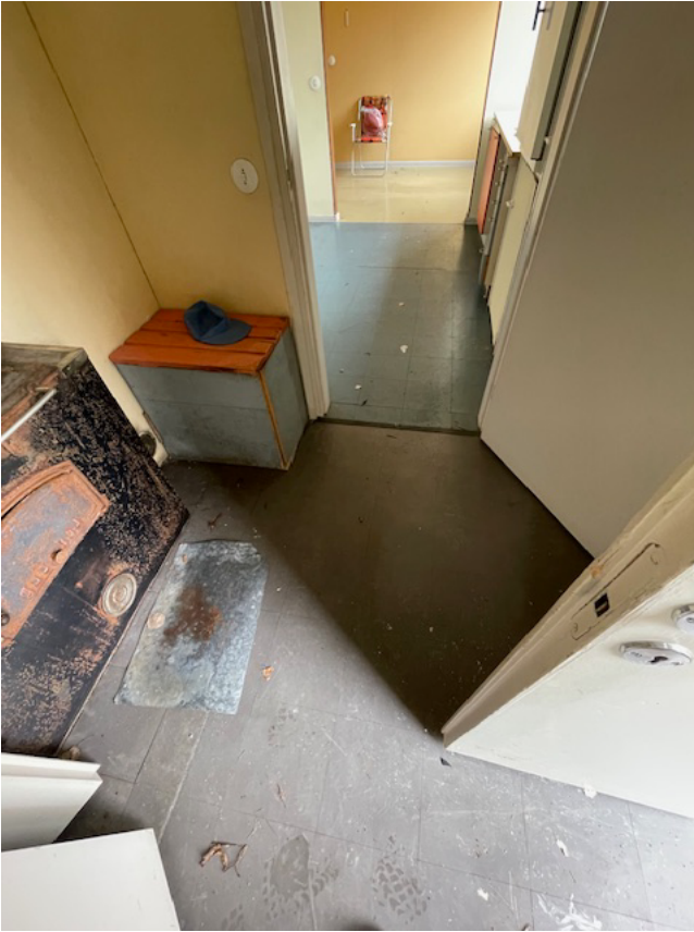
Lattian muovilaatta ja sen musta liima sisältävät asbestia
