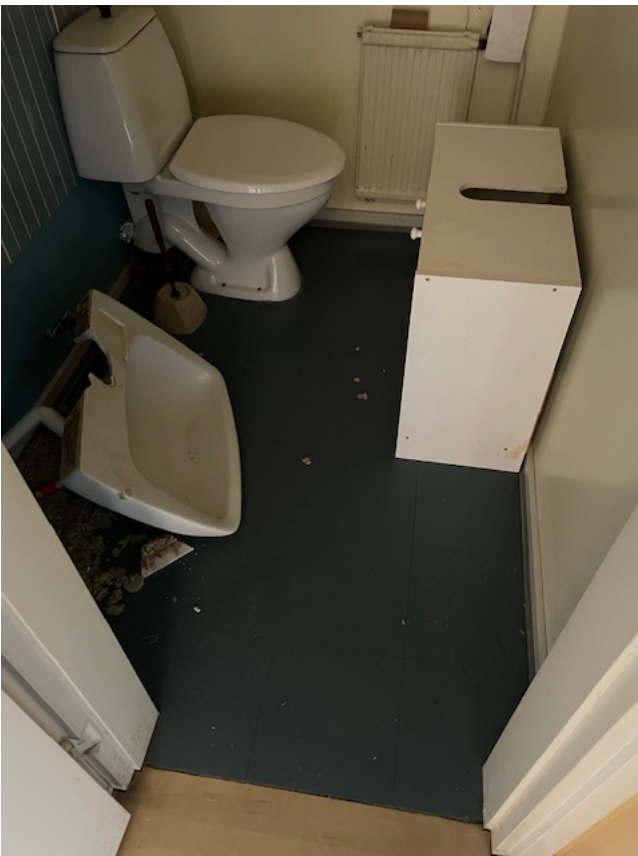
Lattian muovilaatta ja sen musta liima sisältätät asbestia
