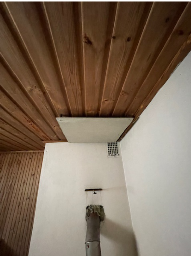
Saunan kiukaan päällä oleva palolevy sisältää asbestia
