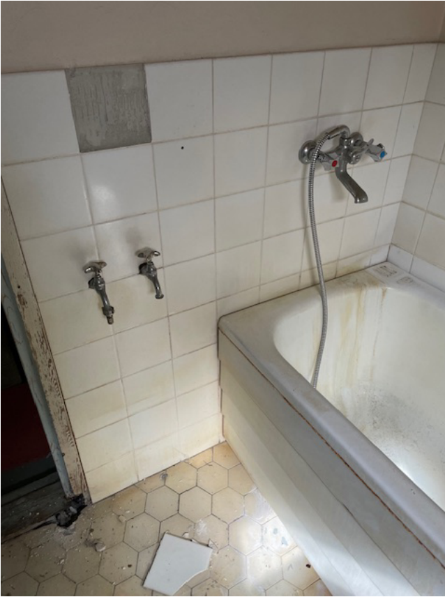
KPH seinälaatoituksen kiinnityslaasti sisältää asbestia
